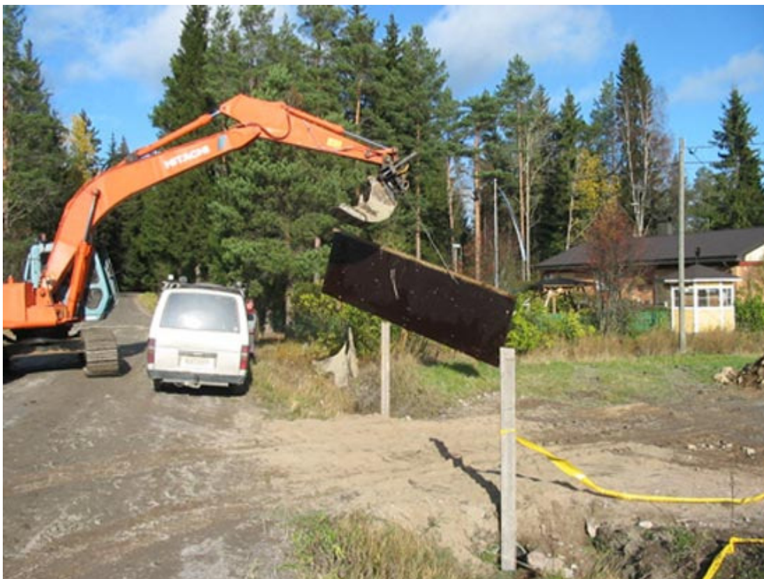
Tässä tehdään pohjapatoa Oskari Kukkumäen tontin vieritse (Äpäntie 281) Haavistonkeitaalta virtaavaan ojaan. Kaivurin kyhdissä keikkuu padon sydän.
